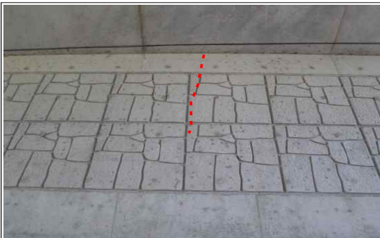
교대 하행선 A1 균열(폭 0.2mm)
