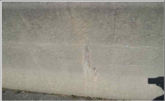
방호벽 밀양·하남방향 S1 균열부 백테
