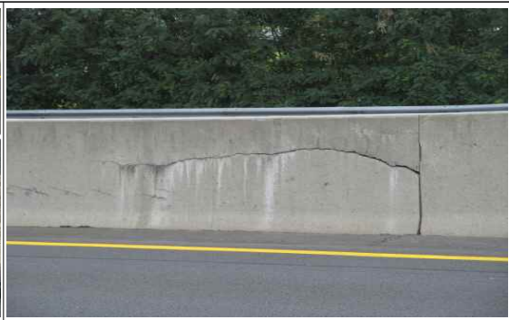
중분대 상·하행선 A2측 접속도로 수평균열(폭 2.0mm)
