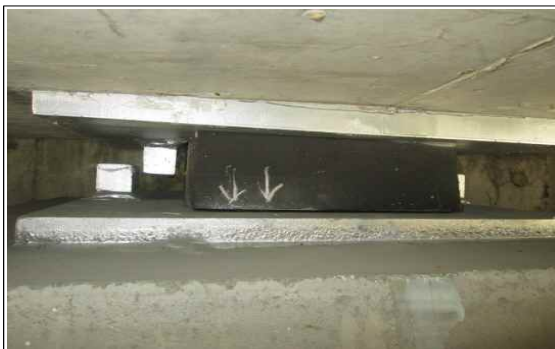
교량받침 상행선 A1 SH1 고무재 하부 들뜸
