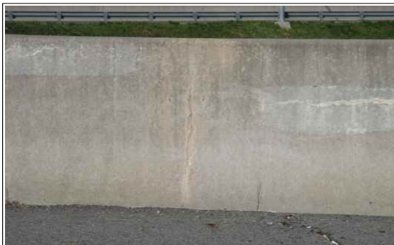
방호벽 S1 균열(폭 0.2mm)
