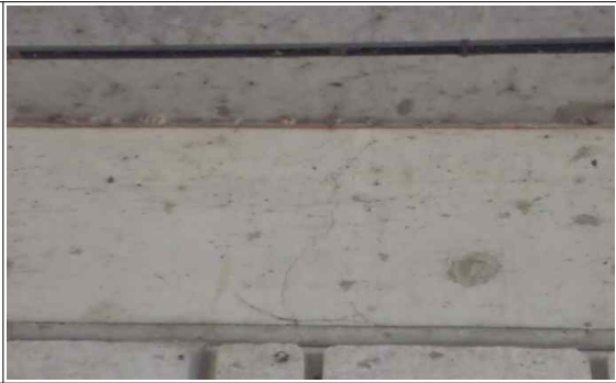
바닥판하면 하행선 S1 균열(폭 0.2mm)
