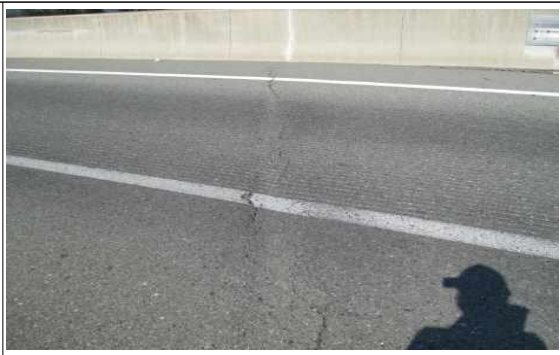
교면포장 A2측 아스콘 균열
