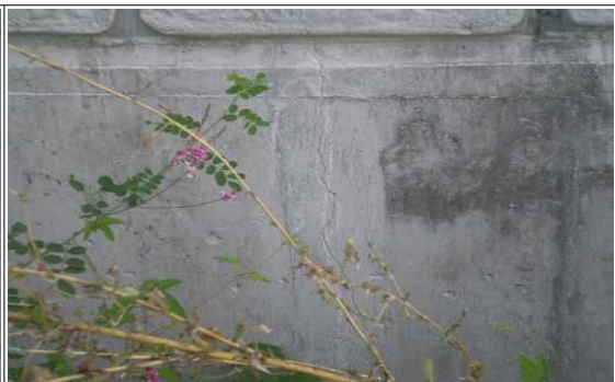
옹벽 하행선 시점측 보수부 재균열(폭 0.2mm)
