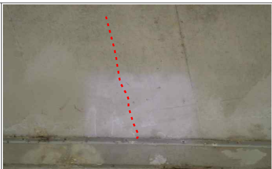
바닥판하면 상행선 S1 보수부 재균열(폭 0.2mm)
