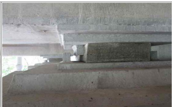
교량받침 상행선 A1 SH4 고무재와 스톱퍼 상호간섭
