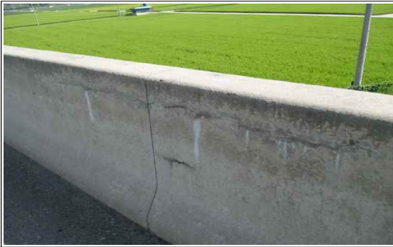
방호벽 상행선 S1 균열(폭 0.1mm)
