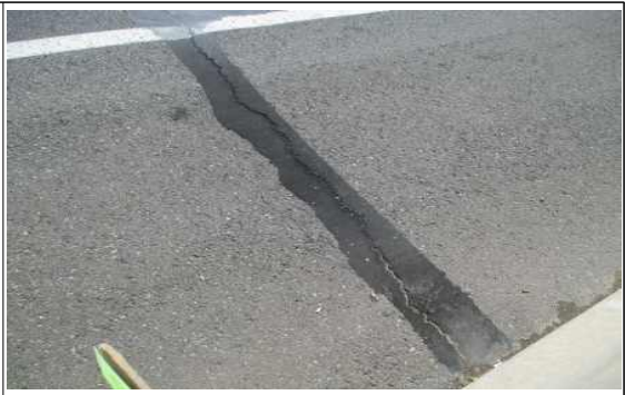
교면포장 밀양·하남방향 S1 아스콘 균열
