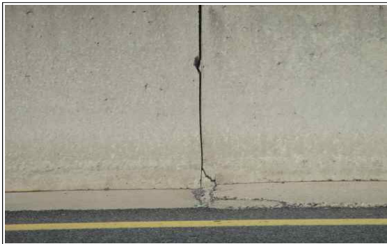
중분대 상행선 S1 콘크리트 박락
