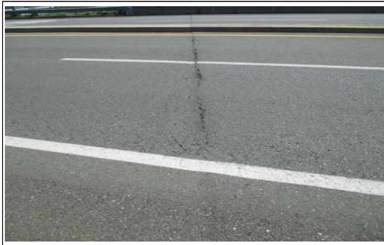
교면포장 밀양·하남방향 S1 아스콘 균열
