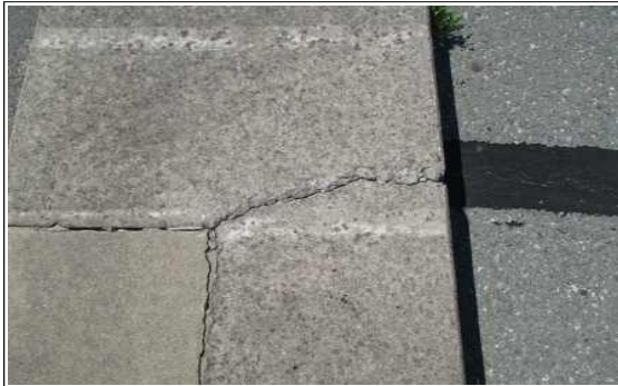
중분대 S1 상면 균열(폭 0.5mm)
