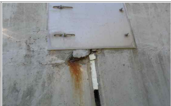
바닥판하면 상행선 S3 측면 콘크리트 박락 및 철근노출
