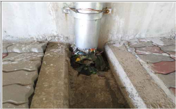
배수시설 하행선 S3 배수관 유출구 이물질 퇴적
