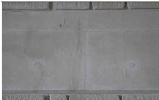
교대 하행선 A2 벽체 보수부 재균열(폭0.2mm)
