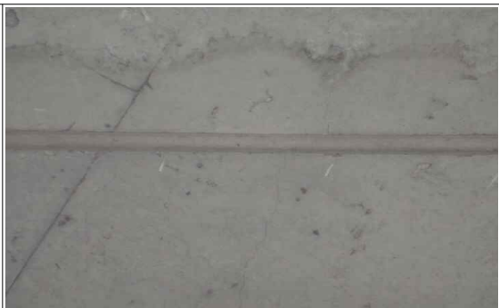
바닥판하면 S1 균열(폭 0.2mm)
