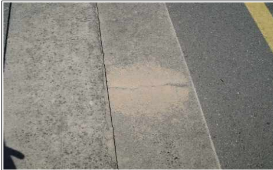
중분대 S1 상면 균열(폭 0.1mm)
