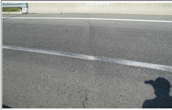
교면포장 A1측 아스콘 균열
