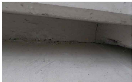
바닥판하면 상·하행선 A1측 유간 부족(홍벽 밀착)
