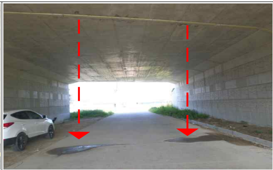
바닥판하면 상·하행선 S1 접합부 누수
