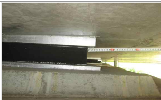
교량받침 하행선 A2 SH4 고무재 밀림
