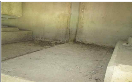
교대 상·하행선 A2 상면 체수흔적
