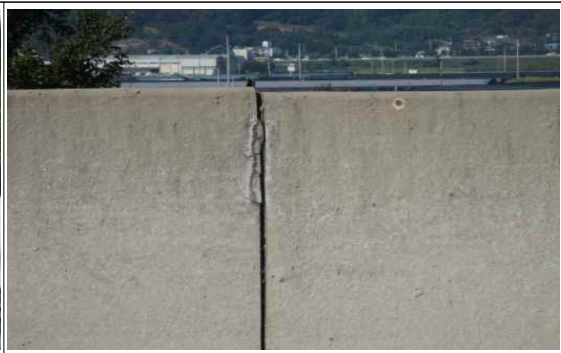
중분대 상행선 S1 콘크리트 박락
