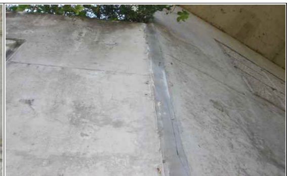
교대 밀양·하남방향 A2 접합부 실란트 손상
