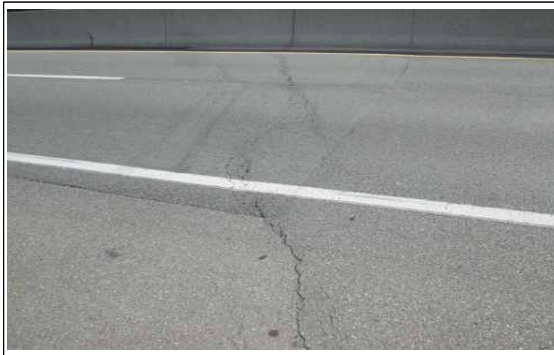
교면포장 하행선 S1 아스콘 균열
