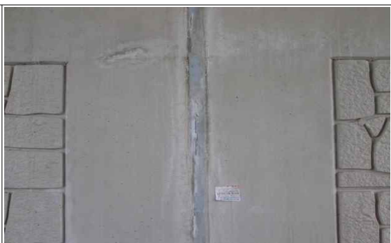
교대 상·하행선 A2 접합부 실란트 손상(보수부 재손상)
