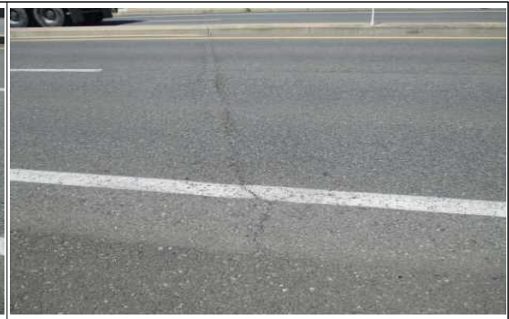
교면포장 대구·부산방향 S1 아스콘 균열
