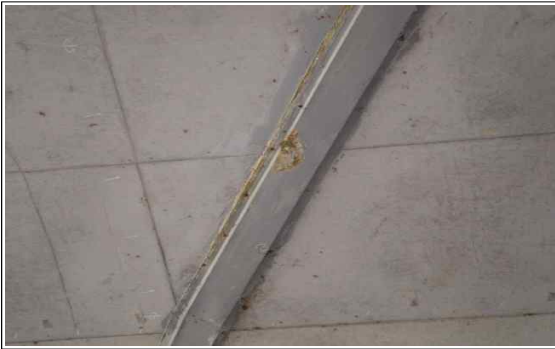
바닥판하면 상·하행선 S1 접합부 누수흔적
