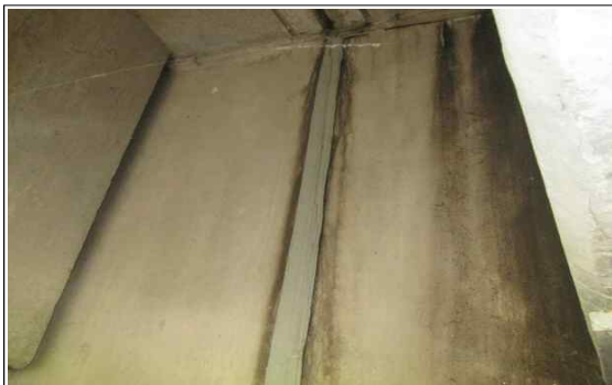
교대 상·하행선 A1 홍벽 접합부 실란트 손상
