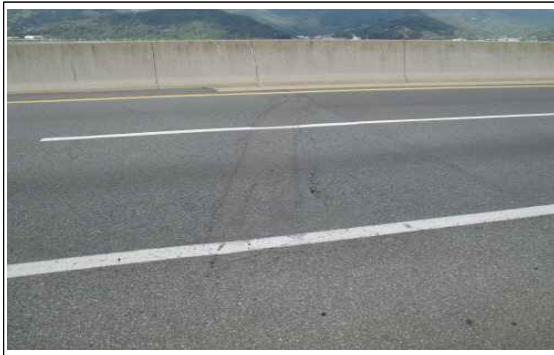
교면포장 상행선 S1 아스콘 망상균열
