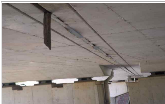
바닥판 하면 상·하행선 S1~S3 실란트 손상 및 누수
