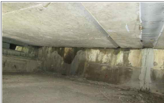
신축이음 하행선 A2 하부 누수(홍벽 누수흔적)
