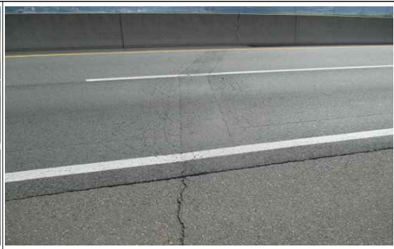
교면포장 하행선 S1 아스콘 균열
