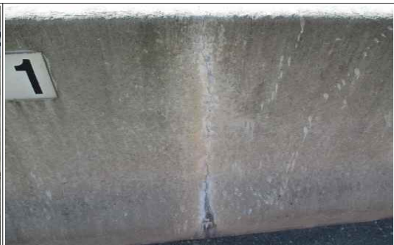
방호벽 하행선 S3 보수부 재균열(폭 0.2mm)
