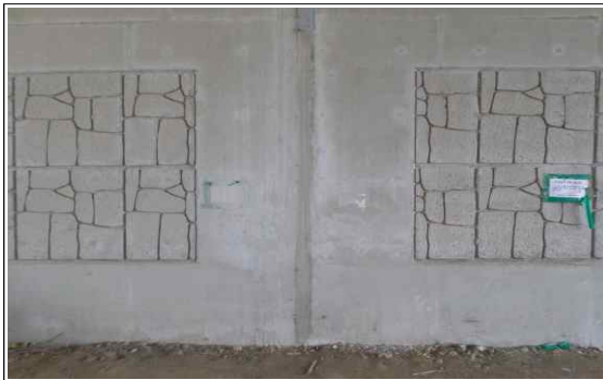
교대 상·하행선 A1 벽체 접합부 실란트 손상
