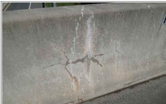
방호벽 상행선 S3 보수부 재균열(폭 0.3mm)
