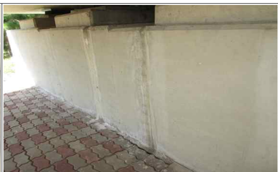
교대 하행선 A2 벽체 누수흔적
