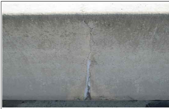
방호벽 상행선 S1 균열(폭 0.3mm)
