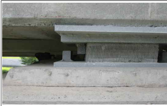
교량받침 하행선 A1 SH1 고무재와 스톱퍼 상호간섭
