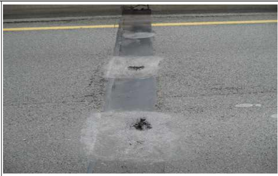
교면포장 하행선 S1 패임(보수부 재손상)
