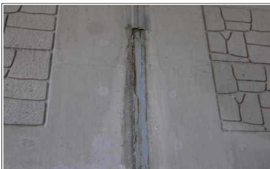
교대 상·하행선 A1 누수흔적(바닥판 하면 접합부누수)
