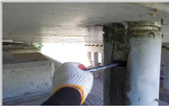
배수시설 상행선 S1 배수관 연결부 불량
