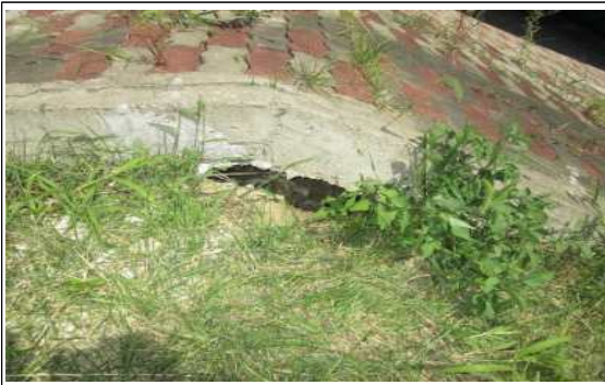
하행선 A2 법면 공동 발생
