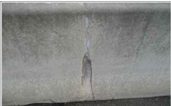
방호벽 하행선 S1 균열(폭 0.5mm) 및 백태
