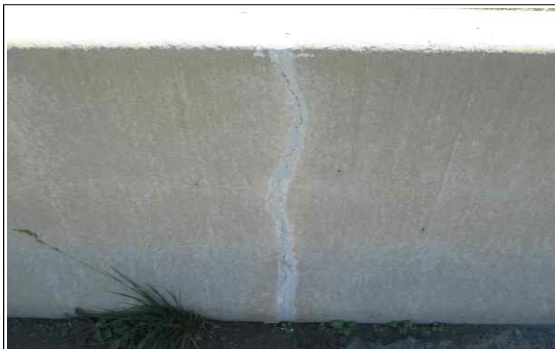
방호벽 대구·부산방향 S1 보수부 재균열(폭 0.2mm)
