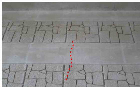
교대 하행선 A2 벽체 보수부 재균열(폭 0.2mm)
