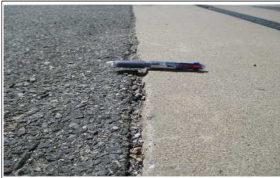
신축이음 상행선 A1 후타재 접속부 이격 및 단차
