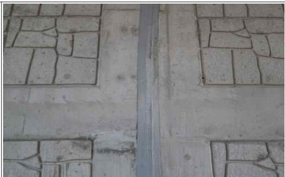
교대 상·하행선 A2 접합부 실란트 손상
