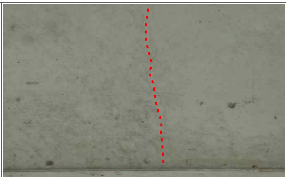
바닥판하면 S1 균열(폭 0.1mm)
