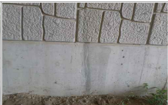
교대 상행선 A2 벽체 보수부 재균열(폭 0.2mm)
