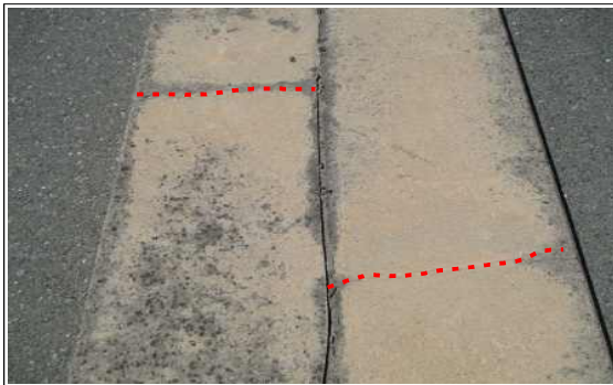
중분대 S1 대구·부산방향 균열(폭 0.2~0.3mm)
