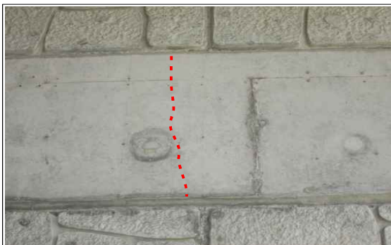
교대 대구·부산방향 A2 균열(폭 0.1mm)
