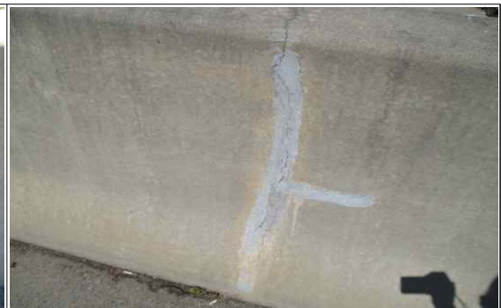
방호벽 밀양·하남방향 S1 보수부 재균열(폭 0.2mm)
