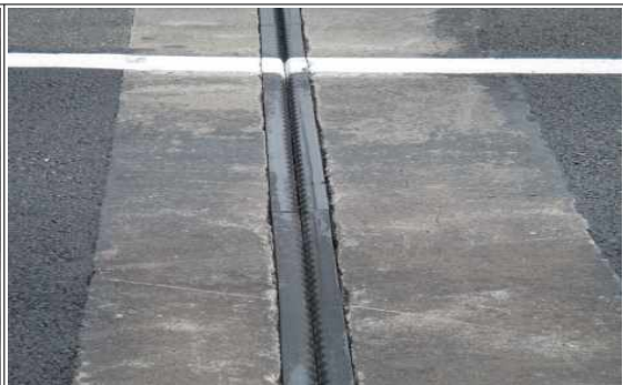
신축이음 상행선 A1 고무재 손상
