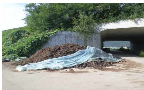
옹벽 상행선 시점측 이물질퇴적
