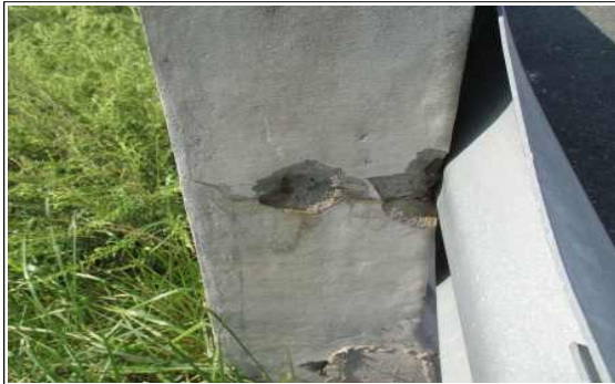
방호벽 S1 콘크리트 박락
