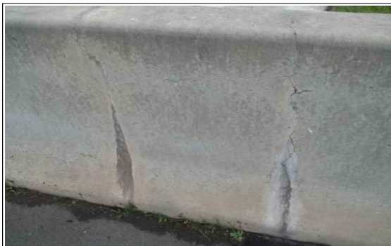
방호벽 상행선 S1 균열부 백태
