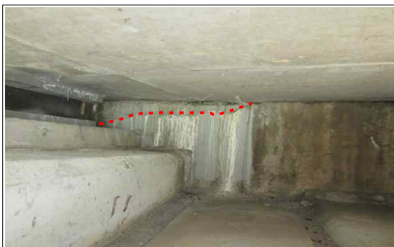
교대 하행선 A1 홍벽 균열(폭 0.2mm) 및 백태
