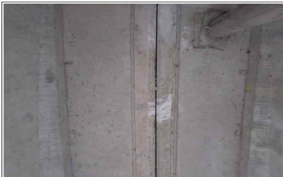
바닥판하면 하행선 S1 백태
