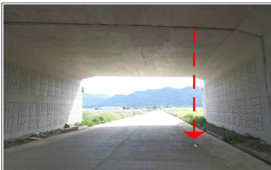
바닥판하면 상·하행선 S1 접합부 누수
